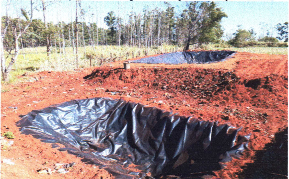
FOTO 6 - Trincheira Impermeabilizada e Lagoa de Acumulação e Recirculação de Chorume
